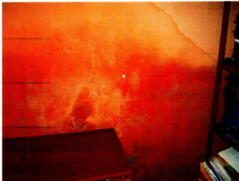
Foto 03 – Detalhe de parede com "umidade excessiva", no Imóvel do autor
