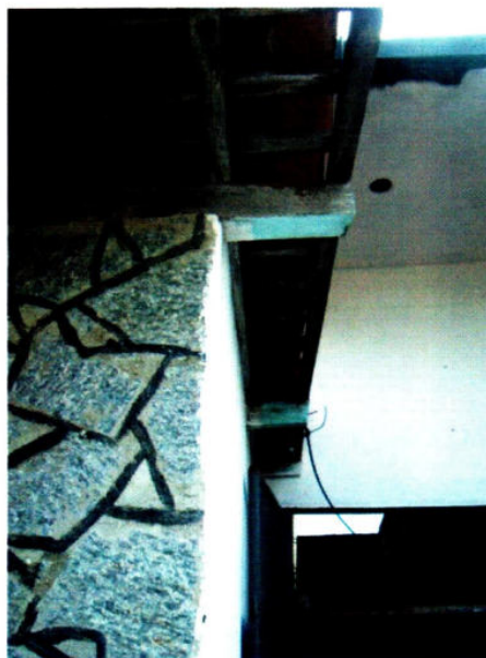
Foto 11 – Detalhe na fachada, e do telhado, do Imóvel do autor
